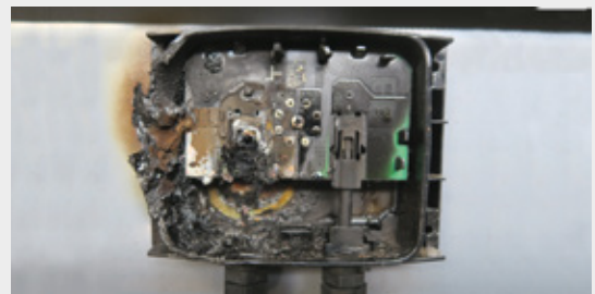
Bild 2: Verbrannte Anschlussdose durch korrodierte Kontakte
